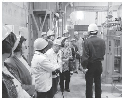
中央ポンプ場内見学風景
