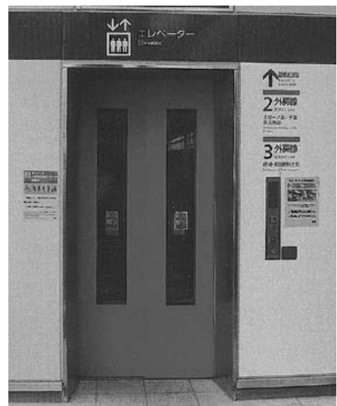
上総一ノ宮駅に設置される同型のエレベーター
