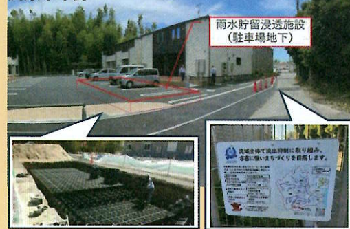
駐車場の地下に貯留浸透施設を設置した事例
