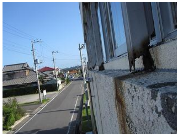
耐震補強部品の腐食
