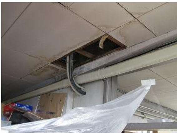
屋上防水機能の劣化による雨漏り
